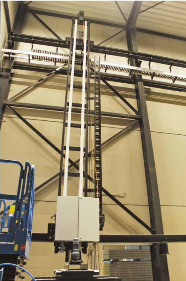
Twee X-assen van 40 meter en 1 Z-as van 9 meter transporteren de grijper door het magazijn met de kweekcellen. De kast beweegt mee met de grijpinstallatie.
